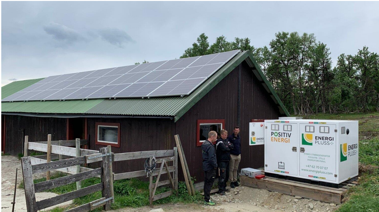
Solceller og battericontainer på Ustuvollen. Foto: EnergiPluss.
