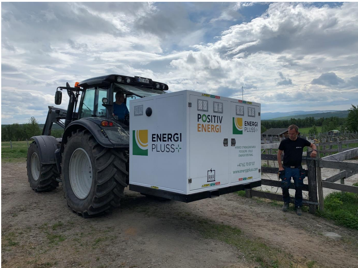
Battericontaineren fraktes hjem til gården mellom driftssesongene på setra. Foto: EnergiPlus.
